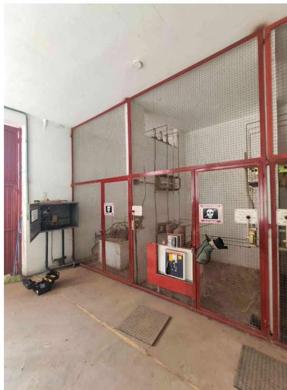
Cubículo de medição interna
