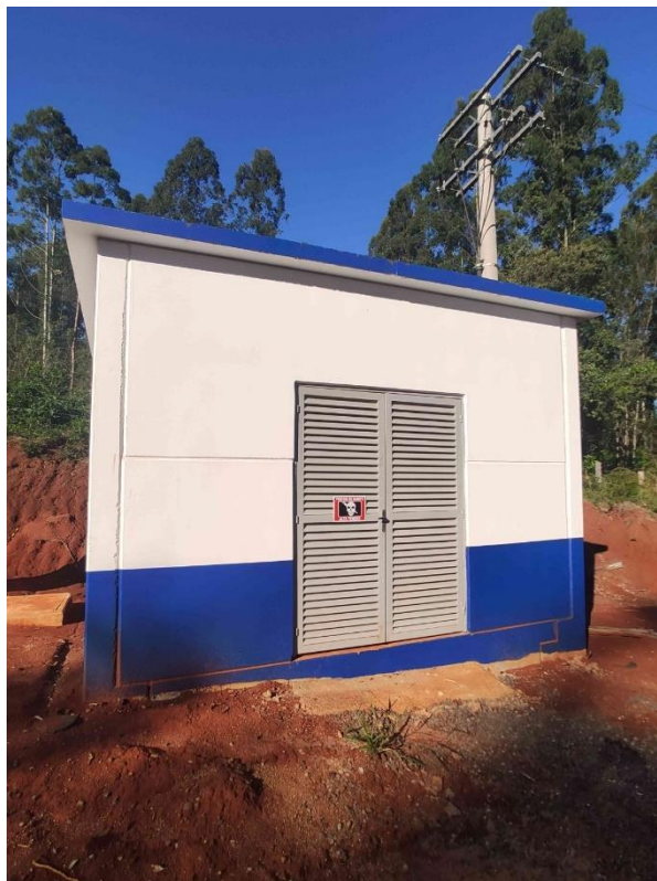
Cubículo de medição externa
